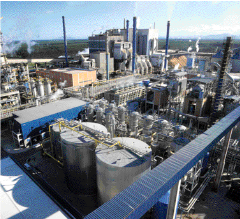
Planta de evaporação de licor negro tipo Falling Film – capacidade 800 tons /hora. ◀ Aracruz – Fiber line C – Evap. D
