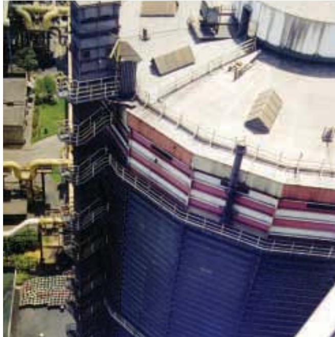
▲ Gasômetro de 48.000 m 3 de capacidade.
